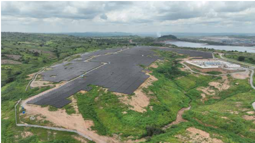
▲ 刚波夫光储柴微电网项目 Kambove Solar-Diesel-Storage Microgrid Project
